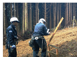
『どこでも丁張』を使用し、若年技術者（入社 4 年目 / 2 年目）だけで丁張設置をしている様子
