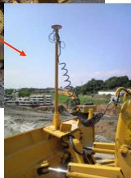
GPSアンテナ(排土板上)
